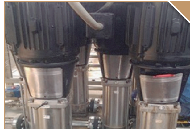
Mantenimiento de bombas de Planta VSEP
