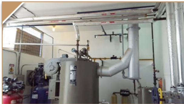
Mantenimiento de instalaciones
