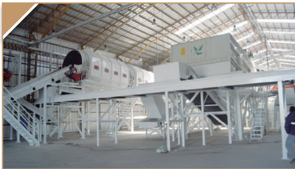
Panorámica interna de la Planta de Separación de Residuos Sólidos
