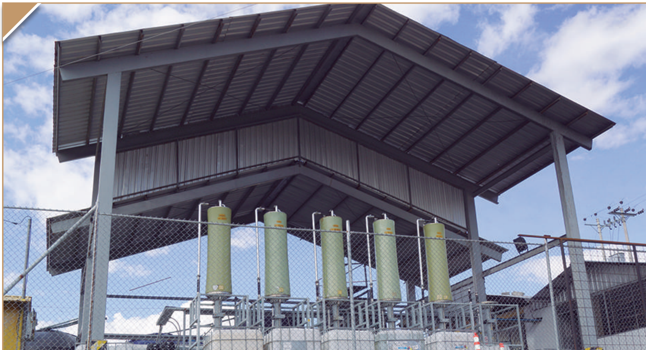
Planta de Tratamiento de Lixiviados VSEP - Sistema de Filtración Vibratoria
