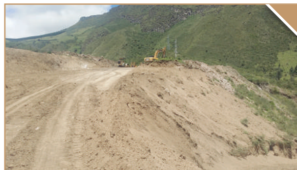
Maquinaria escombrera Piedras Negras
