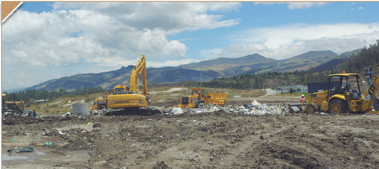
Trabajos de la nueva maquinaria en la disposición final de los residuos sólidos
